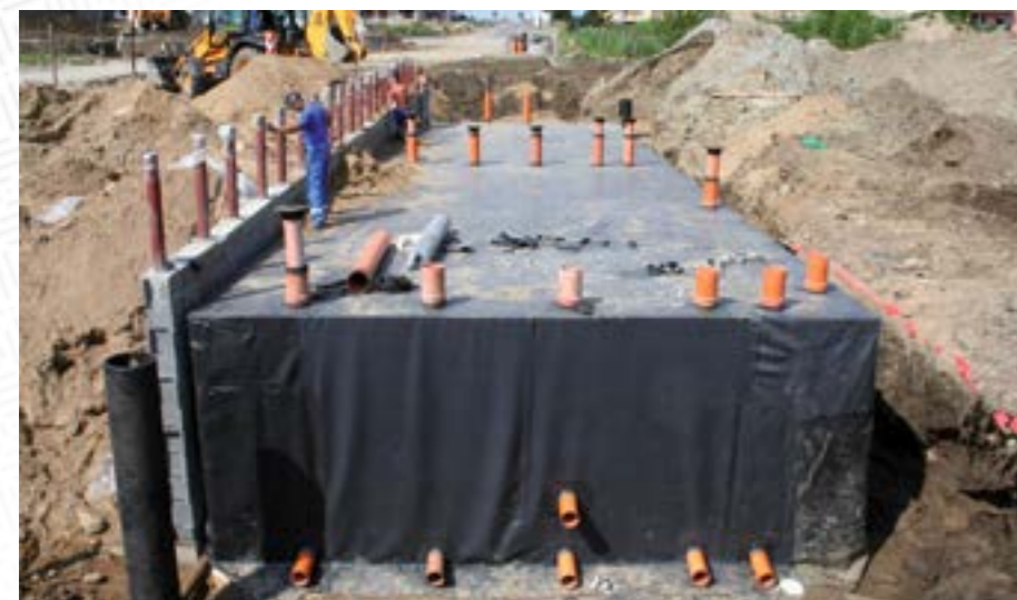
Buffertank in een regenwaterafvoersysteem
